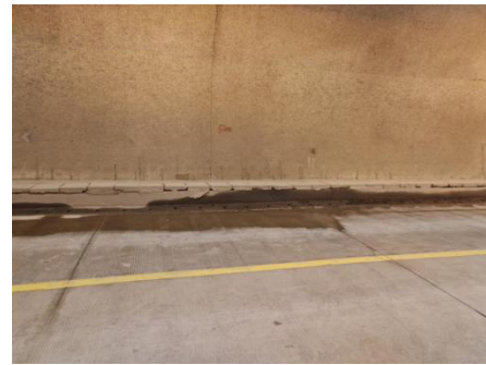
(d) Pavement seepage
